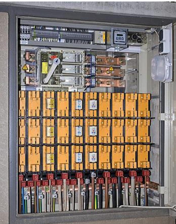
Niederspannung-Hauptverteilung einer Netzstation
