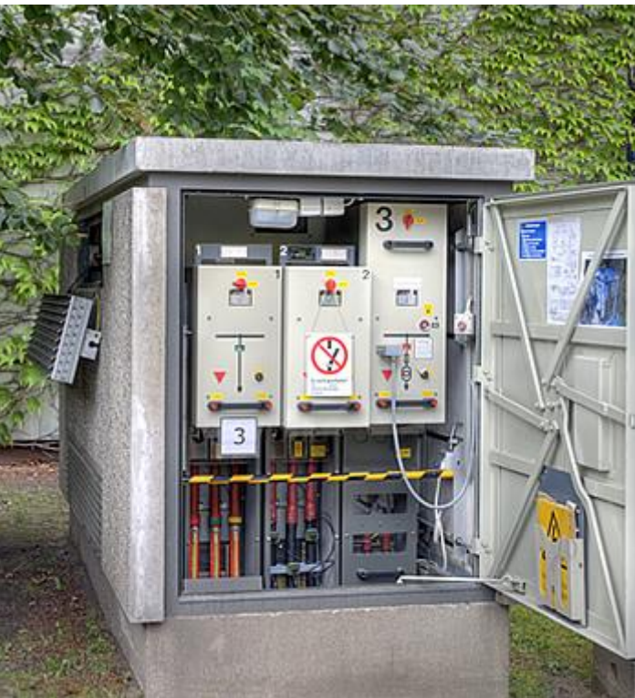
Kompaktstation auf dem Außengelände des Museums
