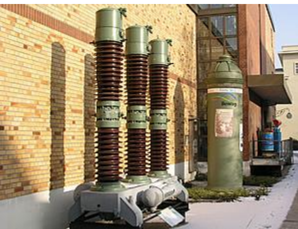
Leistungsschalter für 110 kV (Löschprinzip: Ölströmung)
