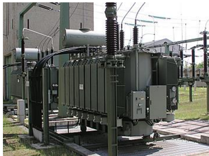
Netztransformator in einer Freiluftschaltanlage
