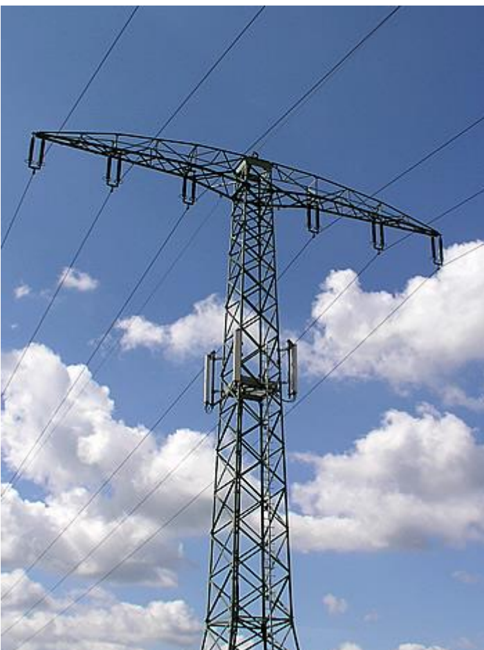
Leitungsmast einer 110-kV-Doppel-Freileitung mit zusätzlichen Mobilfunkantennen
