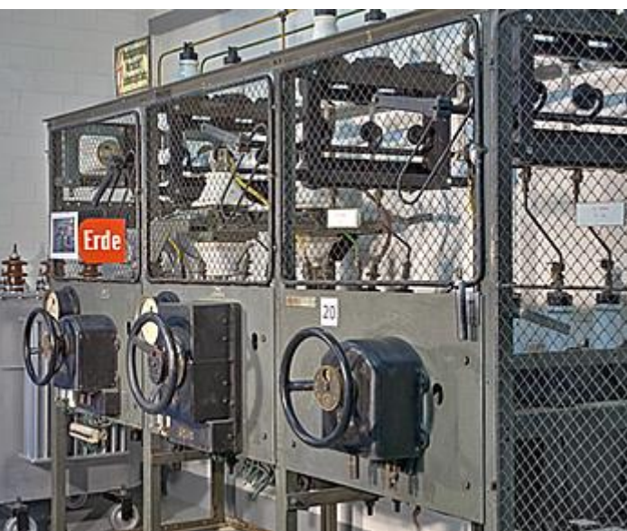
6-kV-Schaltanlage einer Netzstation
