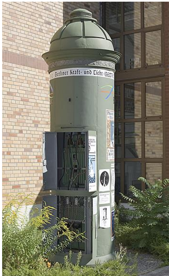
Netzstation in Litfaßsäule
