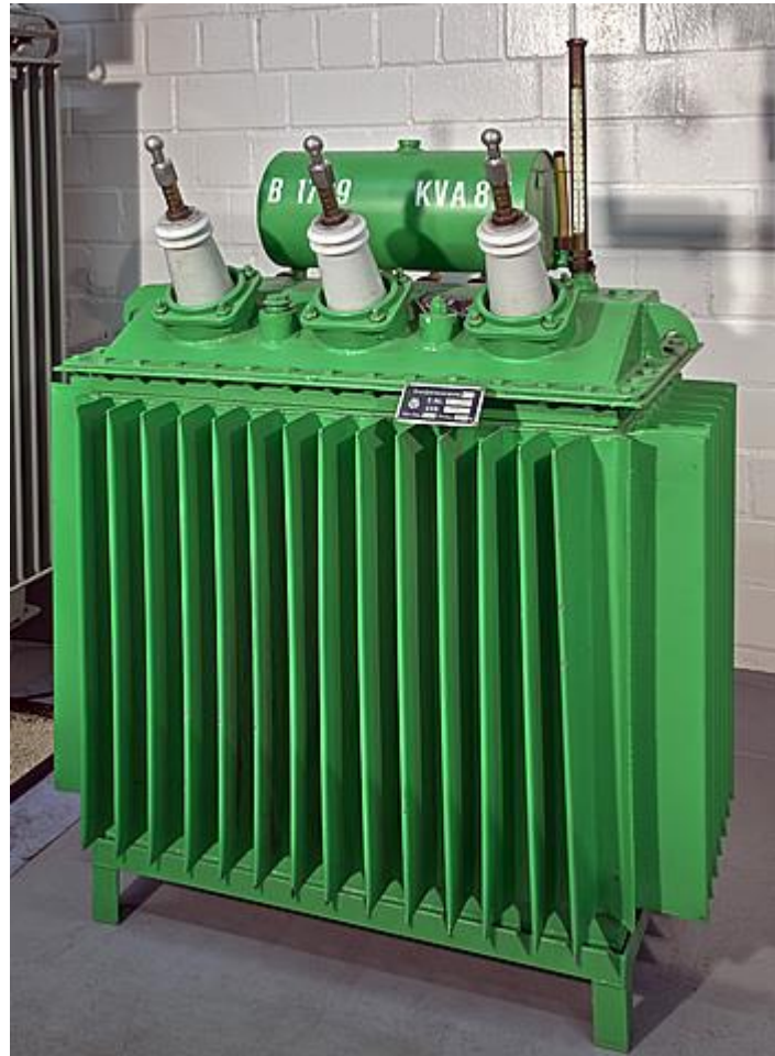
Transformator einer Netzstation
